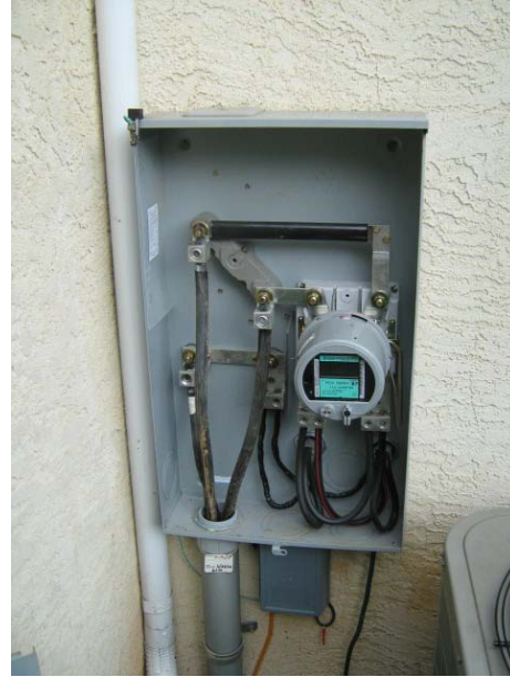
Open Meter Box
