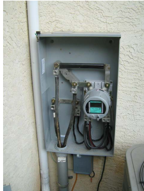
Open Meter Box
